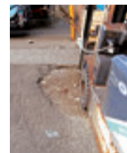
築地市場内のアスファルトの亀裂
